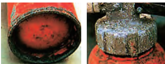
●溶接部とその周辺の腐食 ●キャップ部の腐食
